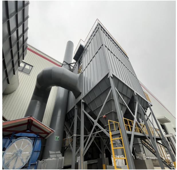
废气污染治理设施
