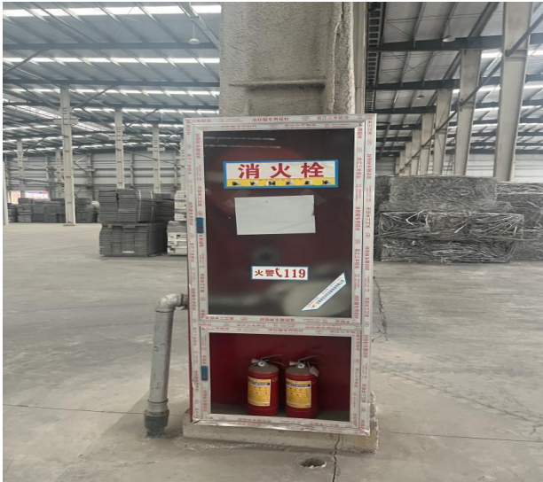
厂区内消防设备
