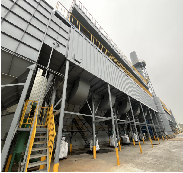
废气污染治理设施
