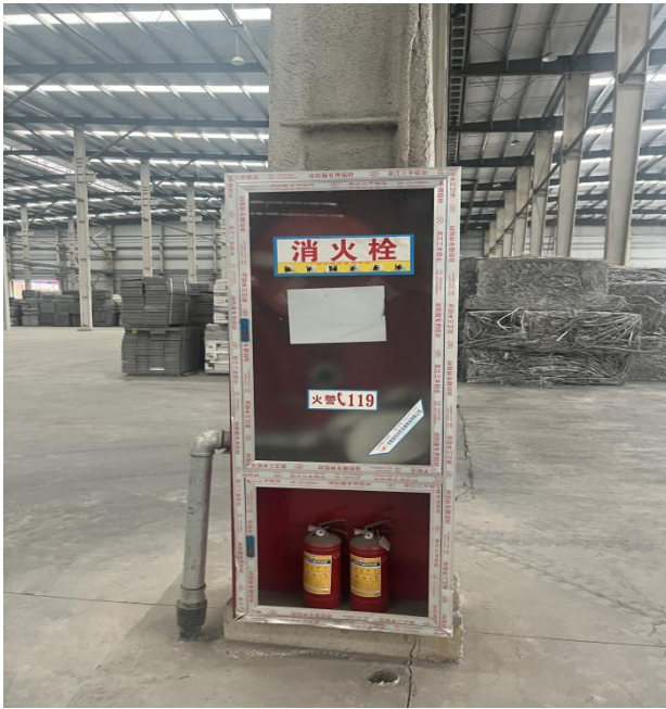
厂区内消防设备
