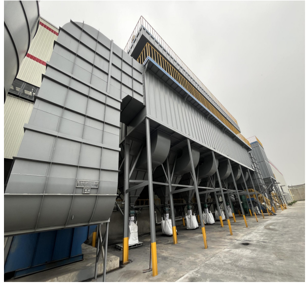
废气污染治理设施
