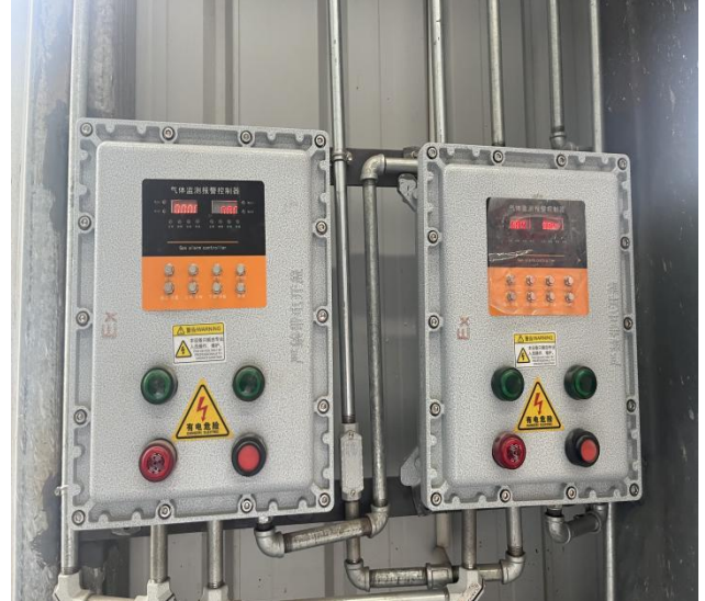
危废暂存间内部气体报警器
