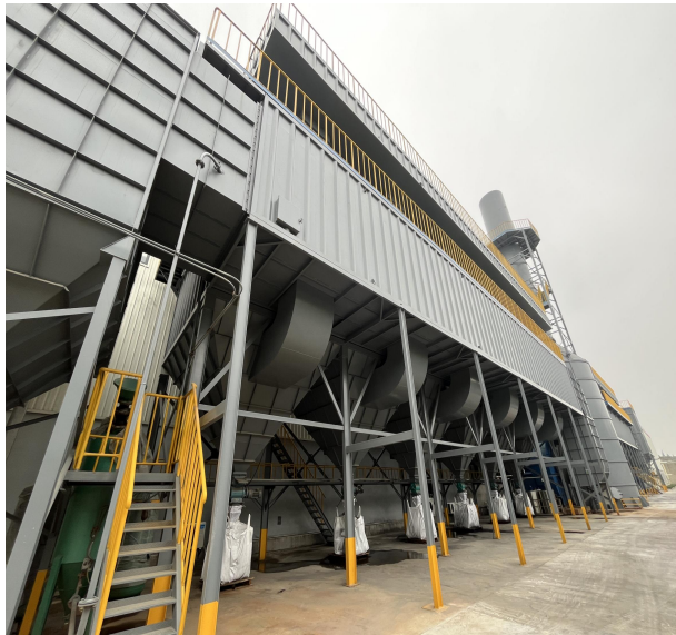
废气污染治理设施
