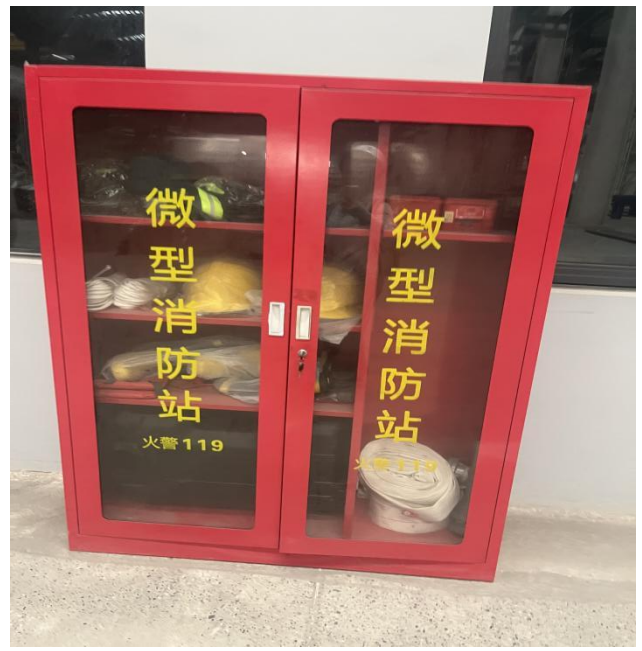
厂区内消防设备
