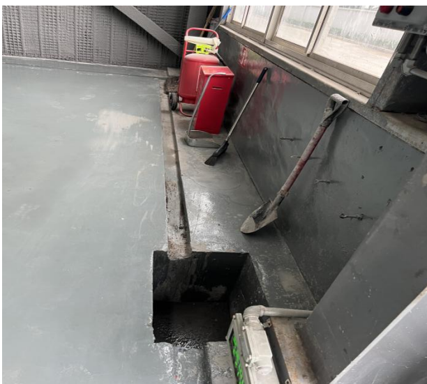
危废暂存间内部导流槽和集液池
