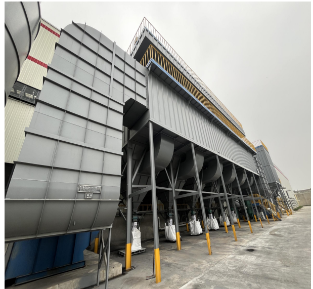
废气污染治理设施
