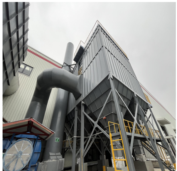
废气污染治理设施
