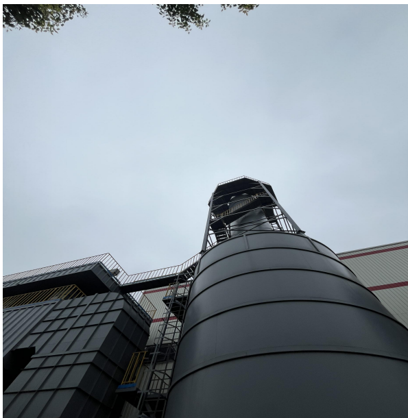
废气污染治理设施
