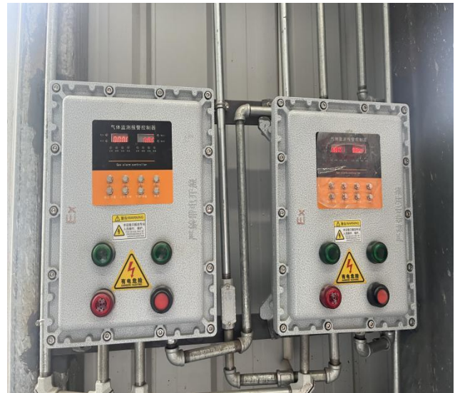
危废暂存间内部气体报警器
