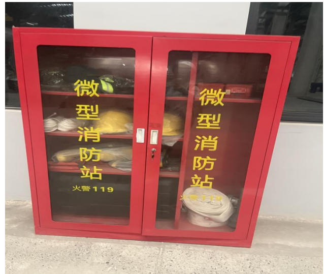
厂区内消防设备
