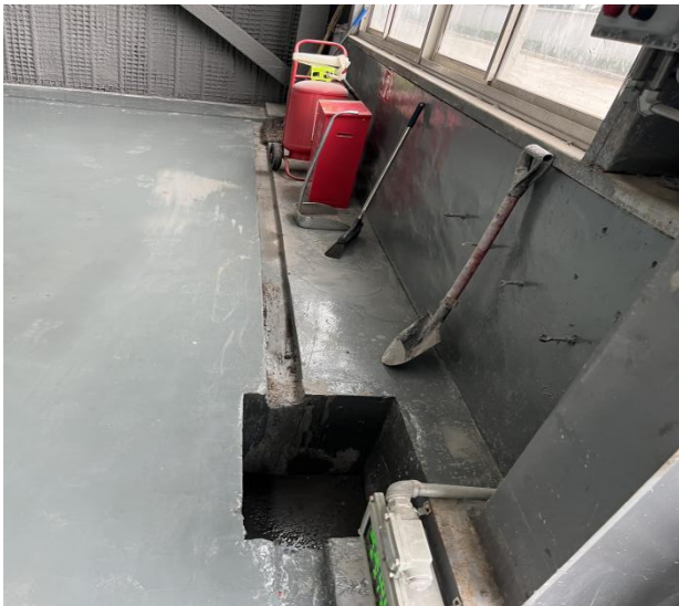
危废暂存间内部导流槽和集液池
