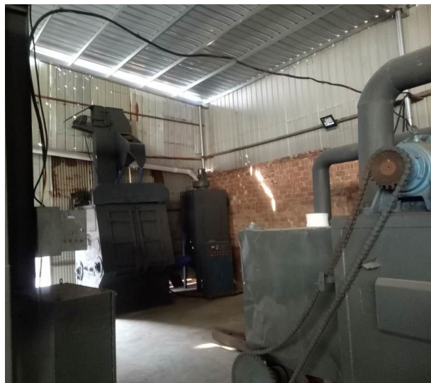
附图4 项目现场照片（整改前）
