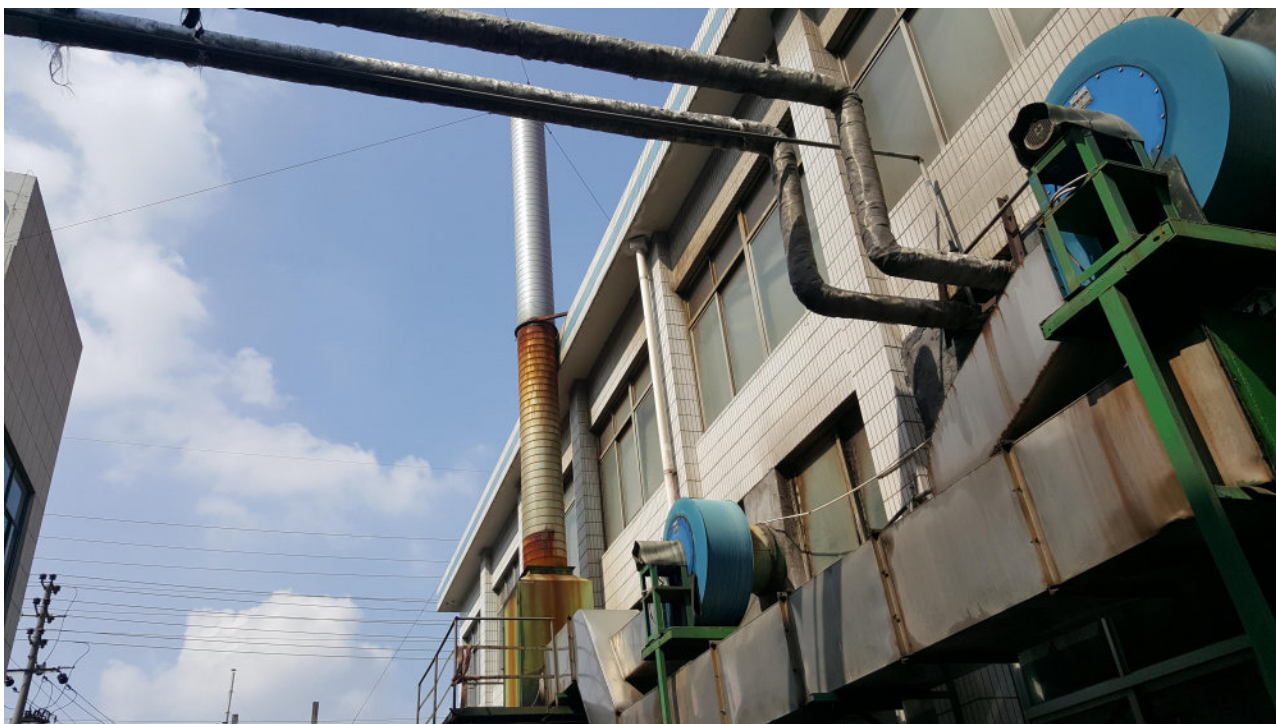
图 4-5 水刺无纺布生产线废气处理设施
