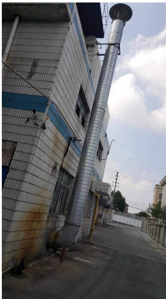
图 4-6 燃烧废气排气筒、
