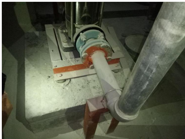
附图 3-5 水泵房减振降噪设施
