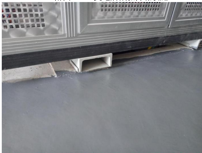
附图 3-10 变电所减振降噪设施
