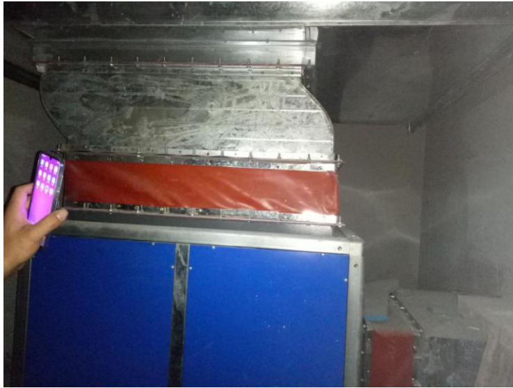
附图 3-8 风机房减振降噪设施
