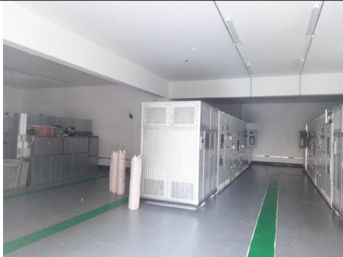
附图 3-9 变电所减振降噪设施
