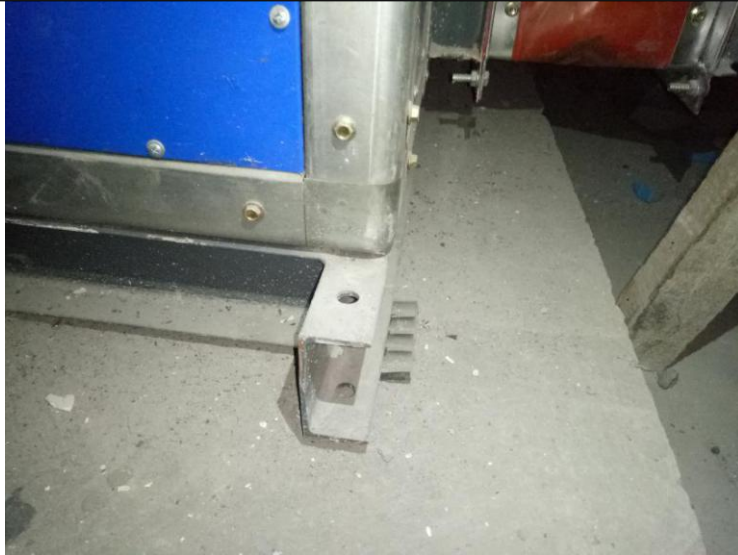
附图 3-7 风机房减振降噪设施
