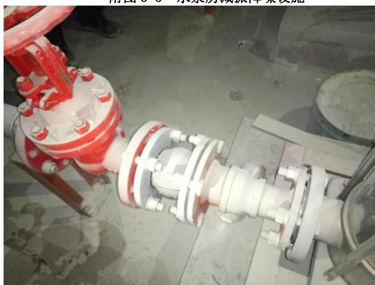
附图 3-6 水泵房减振降噪设施
