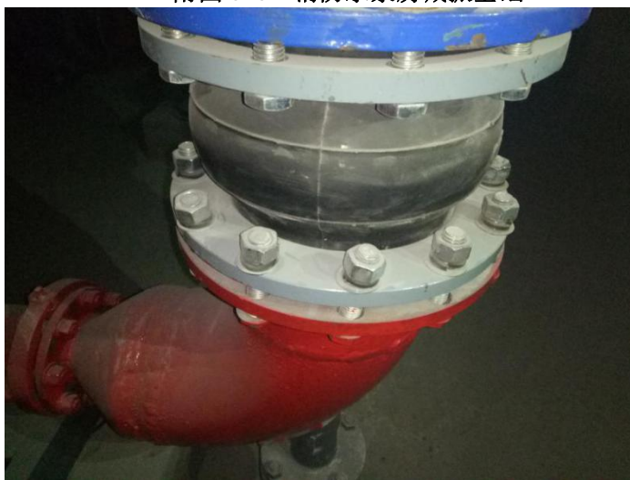
附图 3-9 消防水泵房软管连接
