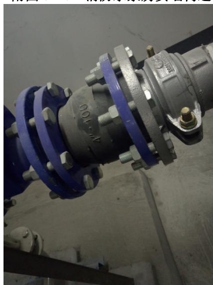
附图 3-11 生活水泵房软管连接
