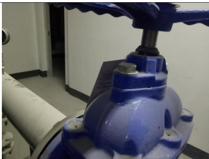
附图 3-13 生活水泵房减振降噪设施
