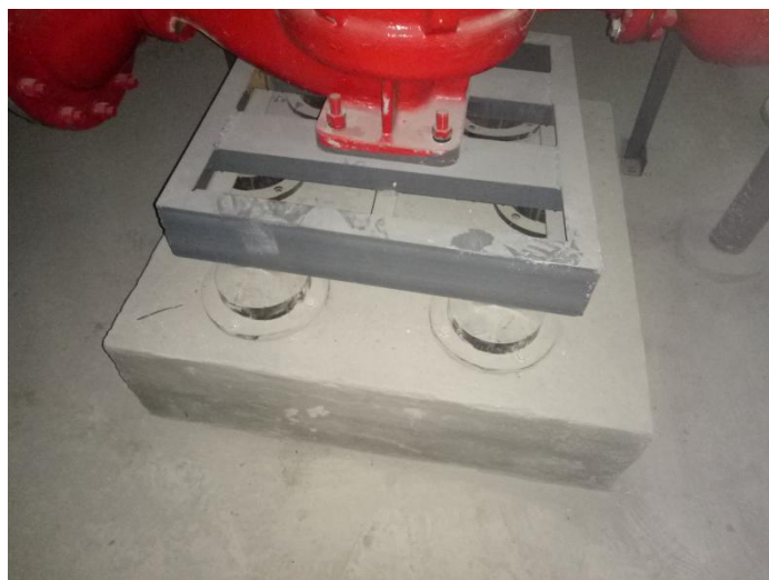
附图 3-8 消防水泵房减振基础
