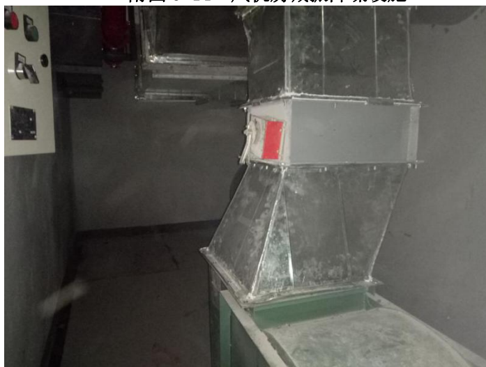
附图 3-15 风机房减振降噪设施
