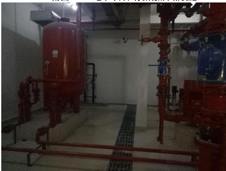
附图 3-8 消防水泵房减振降噪设施
