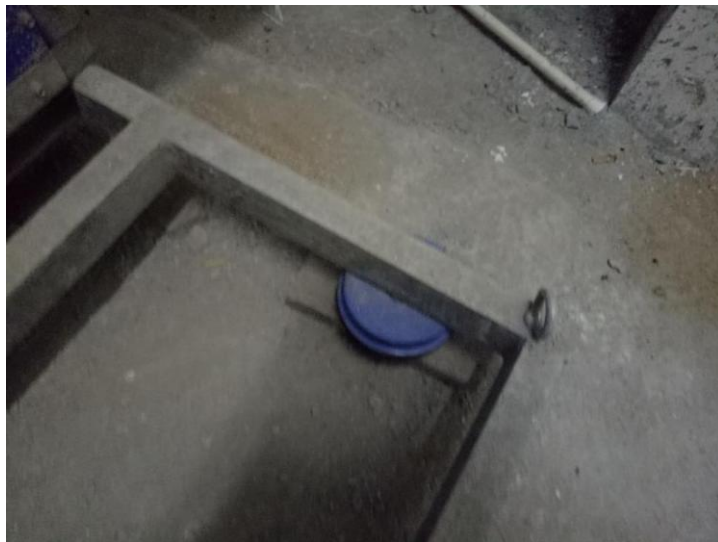
附图 3-6 地下车库风机减振降噪设施
