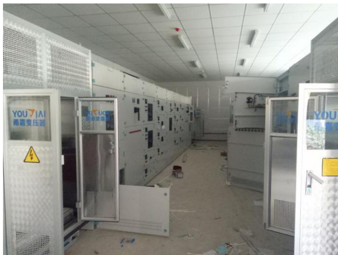
附图 3-10 环网站减振降噪设施
