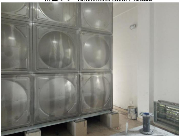
附图 3-9 消防水泵房减振降噪设施
