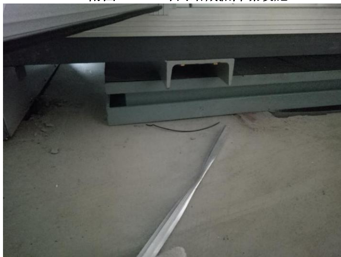
附图 3-11 环网站减振降噪设施
