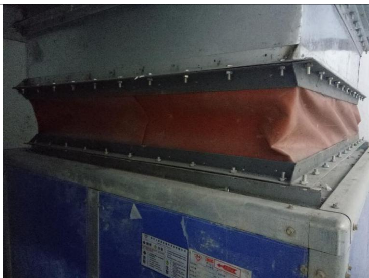
附图 3-7 地下车库风机减振降噪设施
