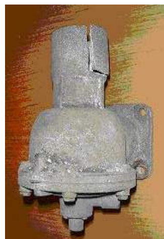
图 6. 现场环境腐蚀性严重，脉冲阀受破坏
