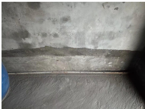
图 7-7 飞灰暂存间（危废暂存间）防渗裙角
