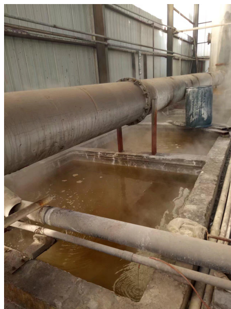
图 7-4 喷淋塔循环水池
