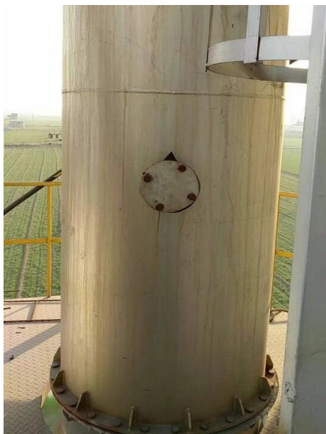
图 7-5 焚烧炉排气筒采样孔
