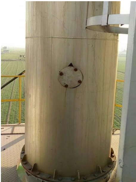
图 7-5 焚烧炉排气筒采样孔
