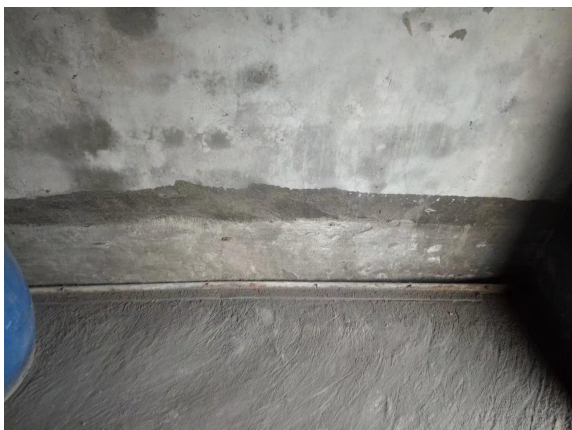
图 7-7 飞灰暂存间（危废暂存间）防渗裙角
