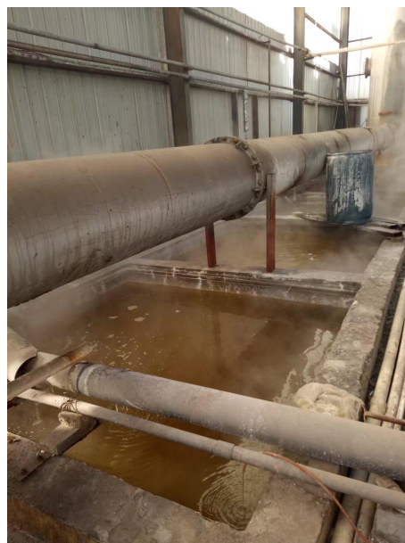
图 7-4 喷淋塔循环水池
