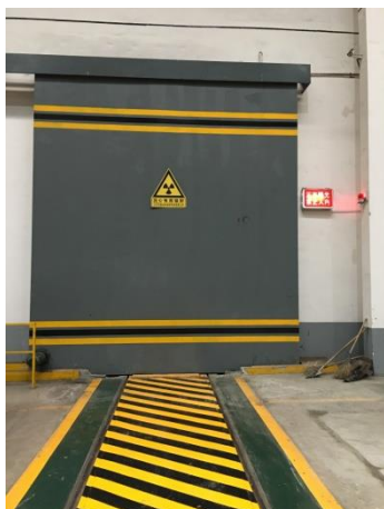
图 6-1 三号探伤室工件门电离辐射标志
