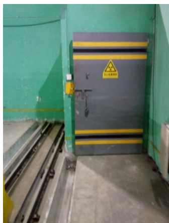
图 6-3 三号探伤室内源库
