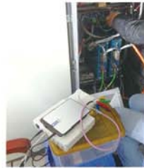
▲ 白云机场气象雷达故障排查
