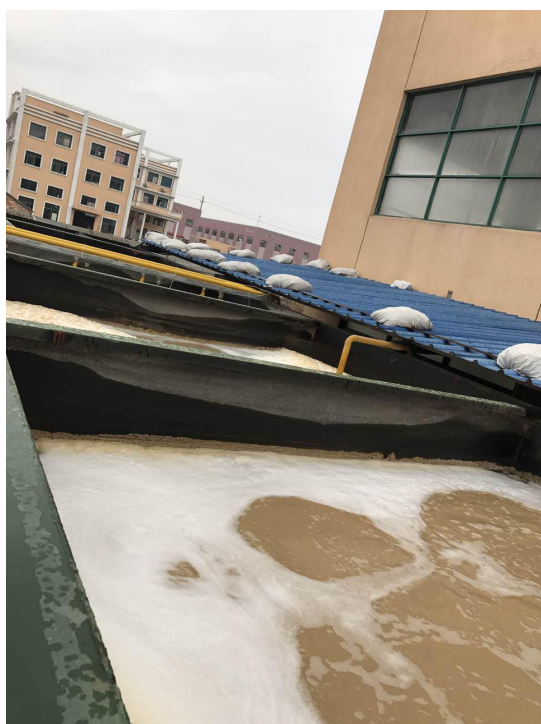
废水生化处理设施
