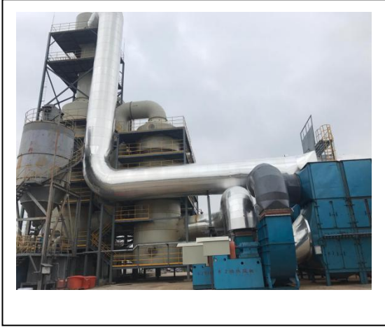
烟气脱硫塔全貌
