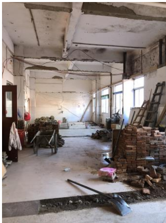
介入室机房现状
