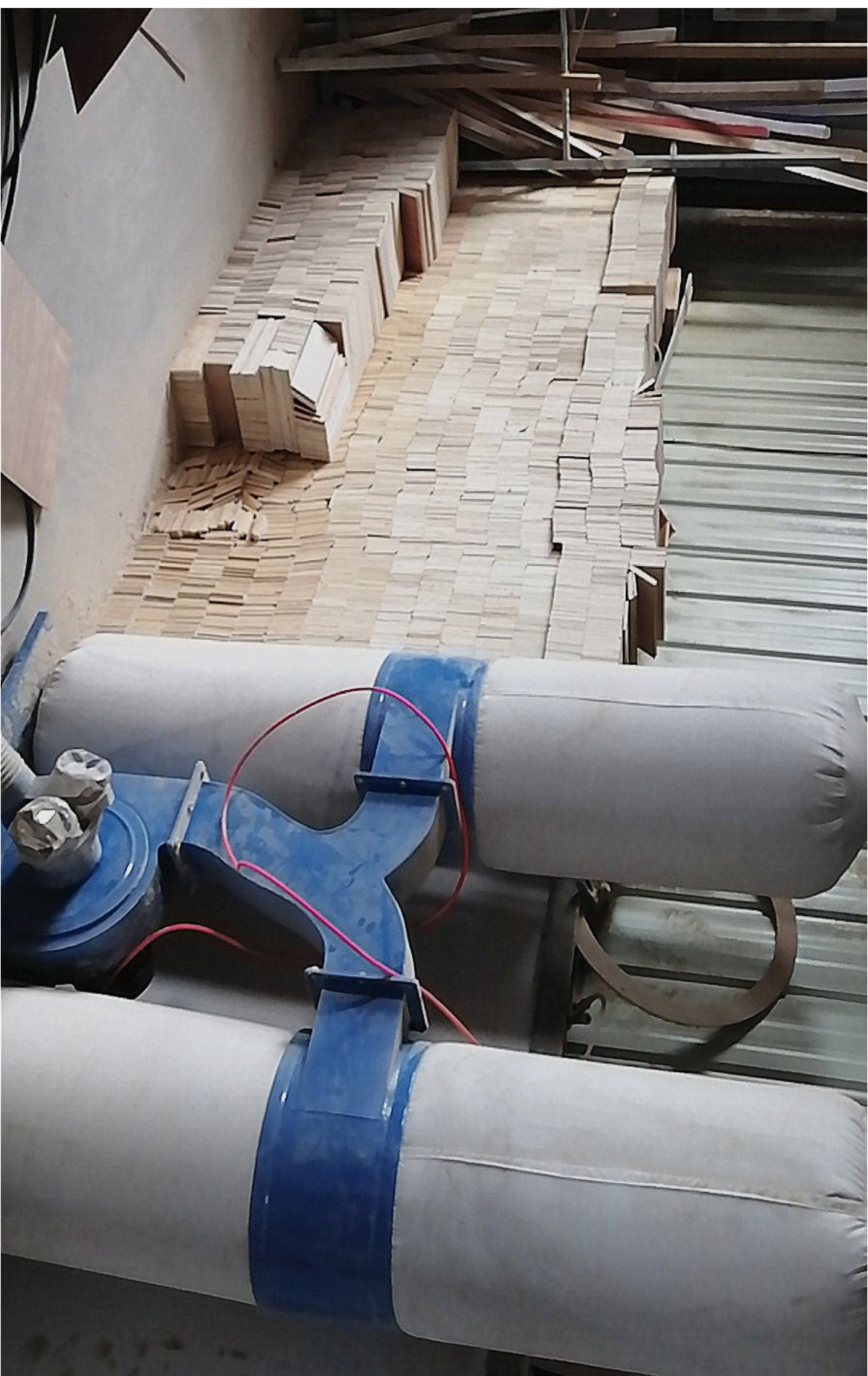
废气处理设施-布袋除尘器
