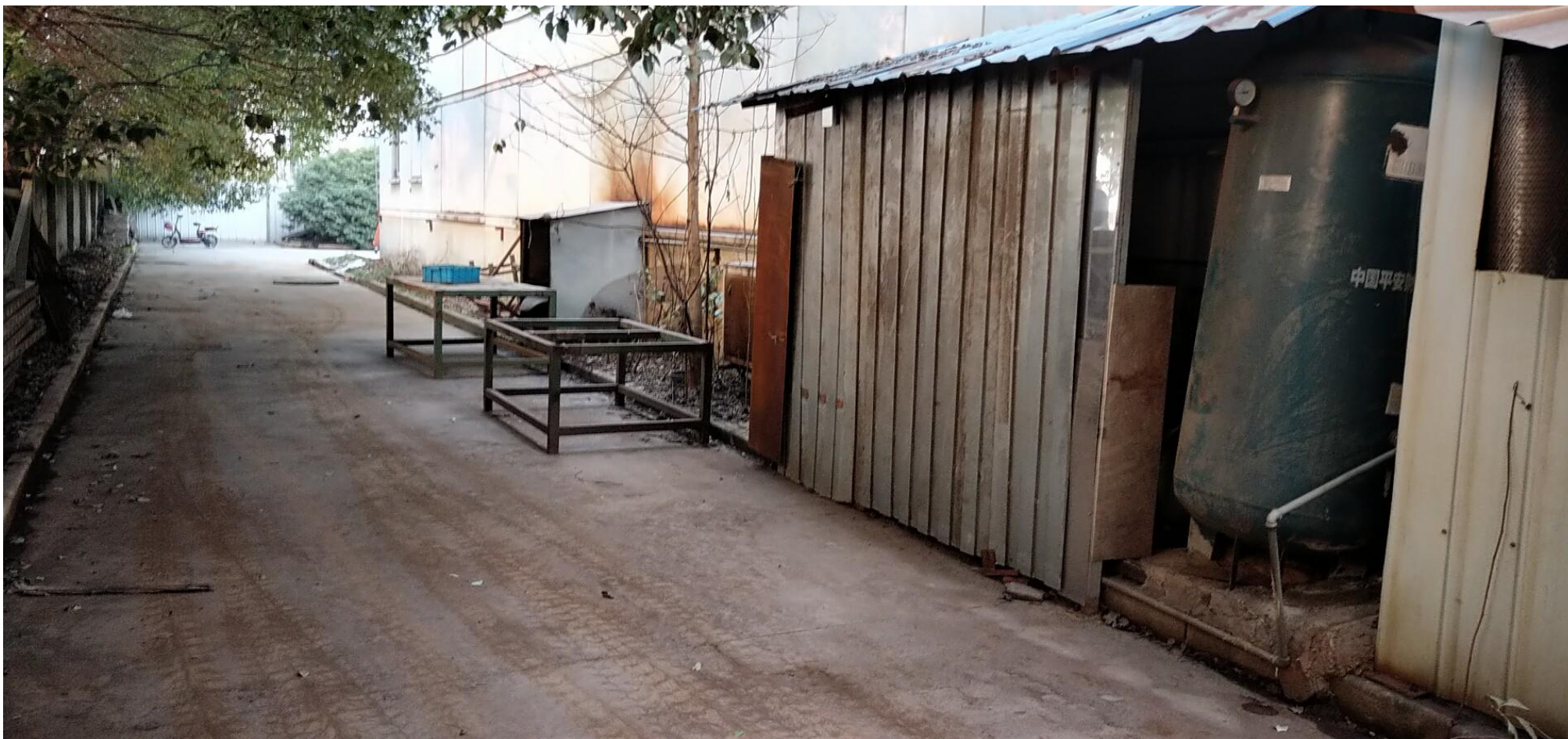
附图5 空压机房
