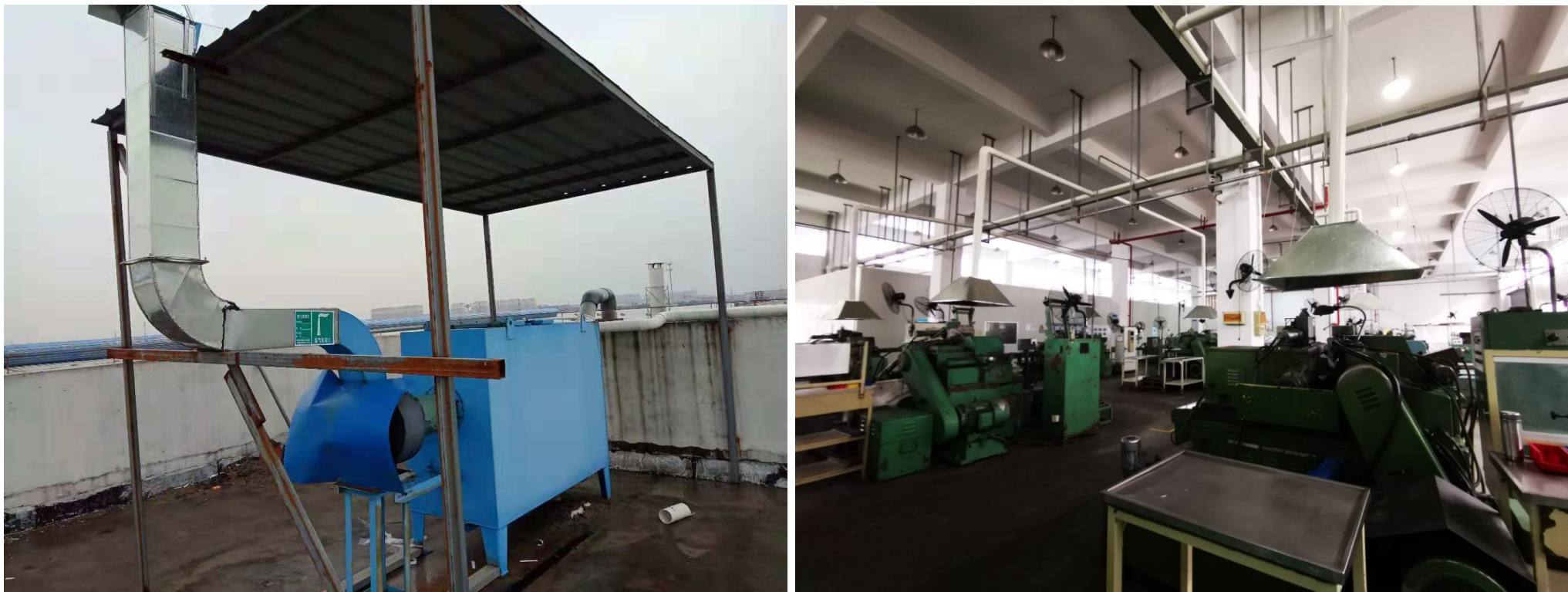
附图 6-1 4#车间废气处理设施实景图
