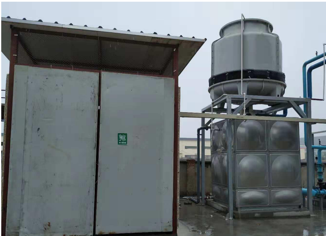
附图 6 空压机房（左、设隔声措施）、冷却塔（右）
