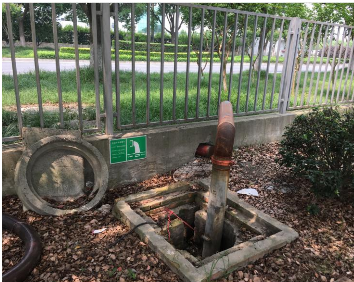
生活污水排口
