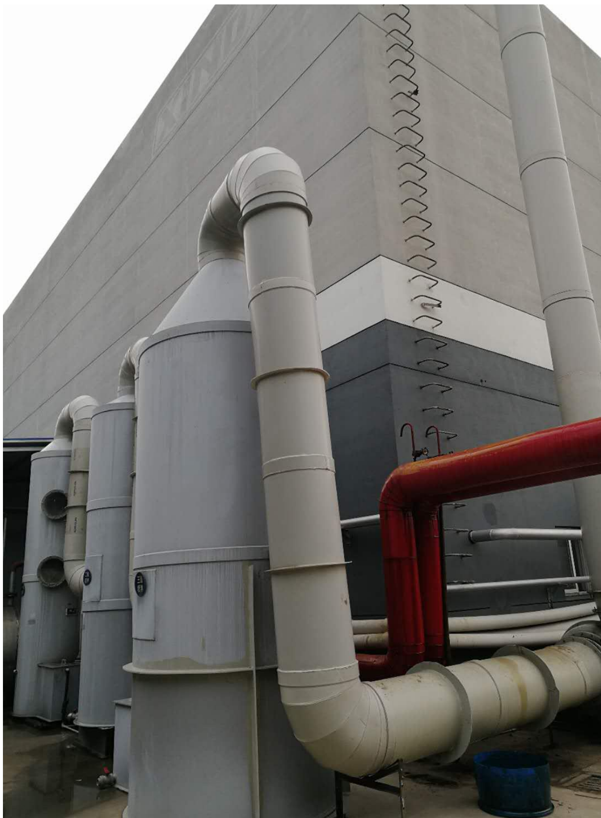
废气处理设备
