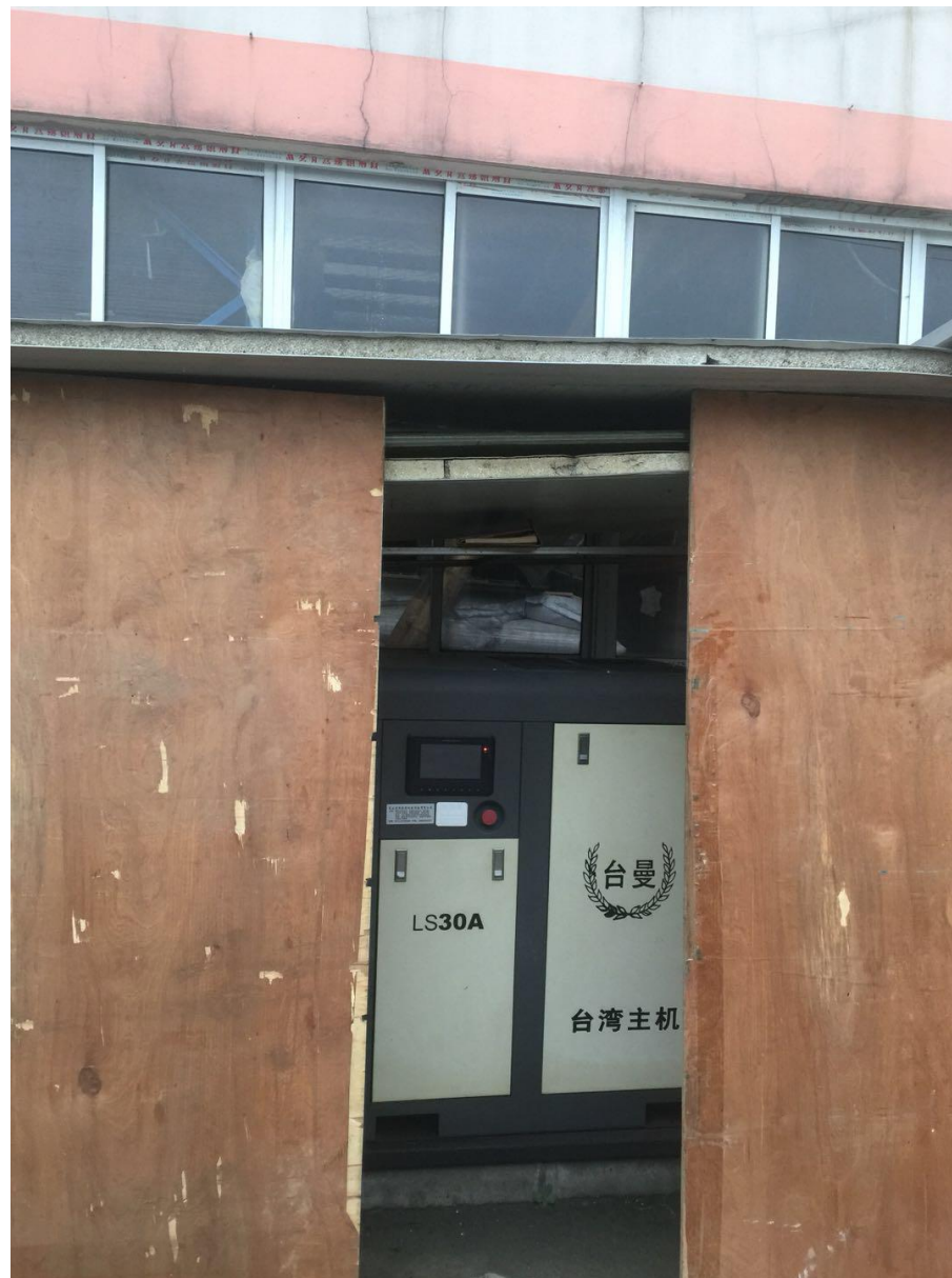
附图 5-2 项目空压机房
