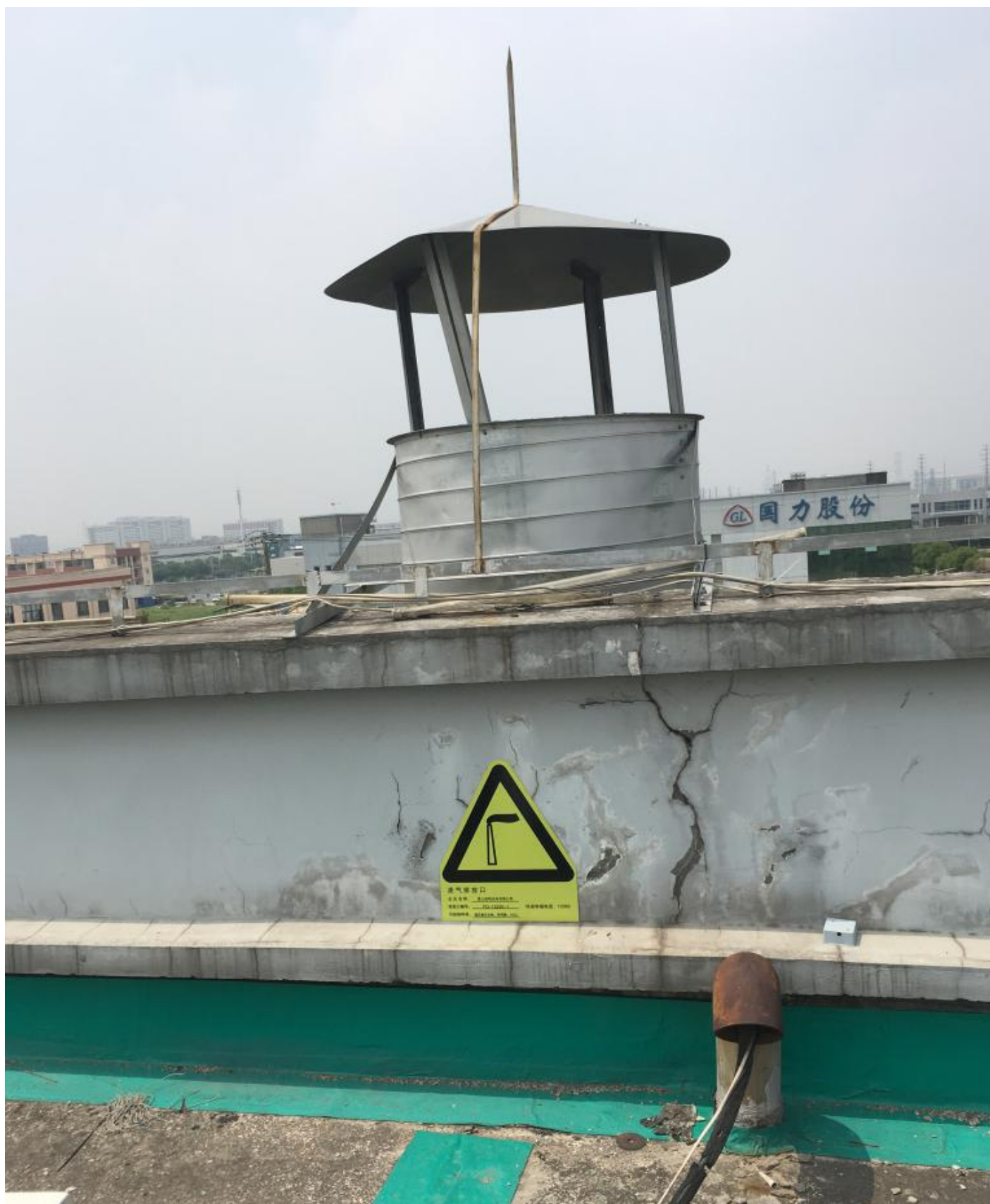
1 楼车间车间排筒
