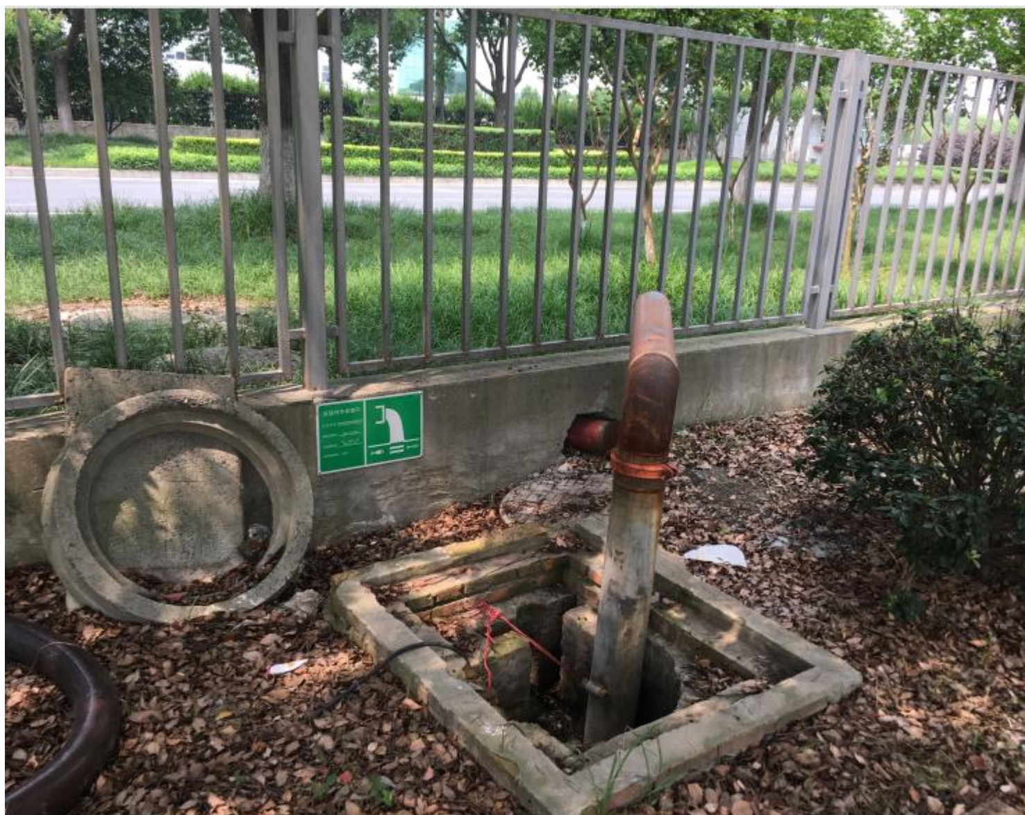
生活污水排口
