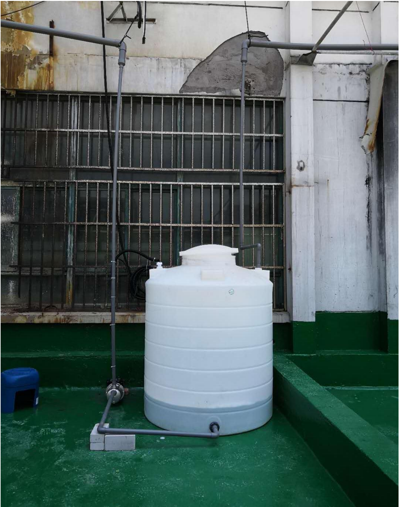
附图 5 生产废水收集槽（原水采样口）
