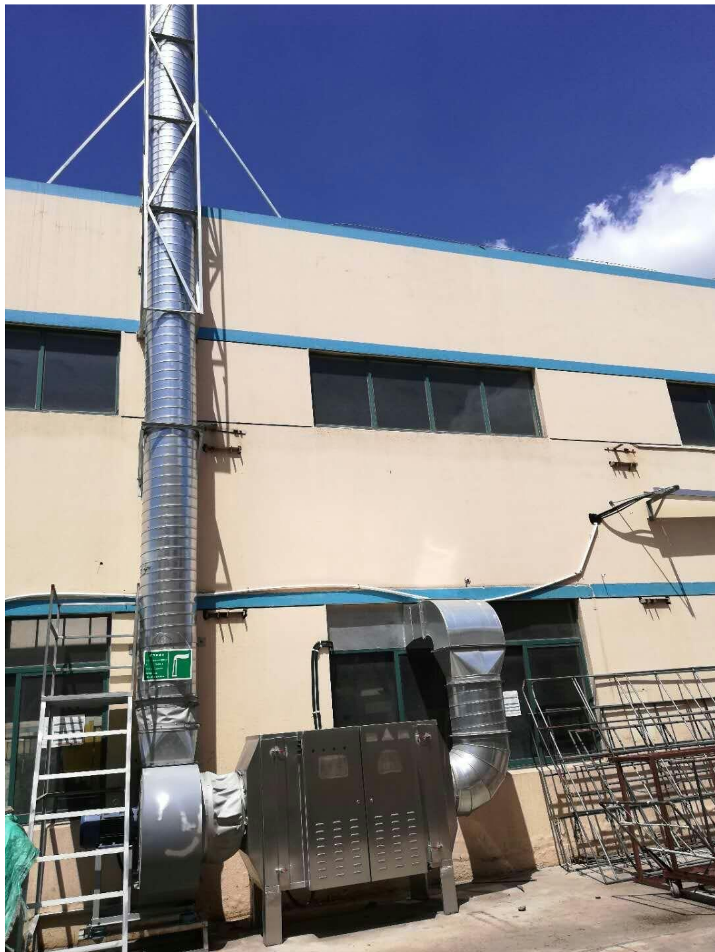
废气处理装置
