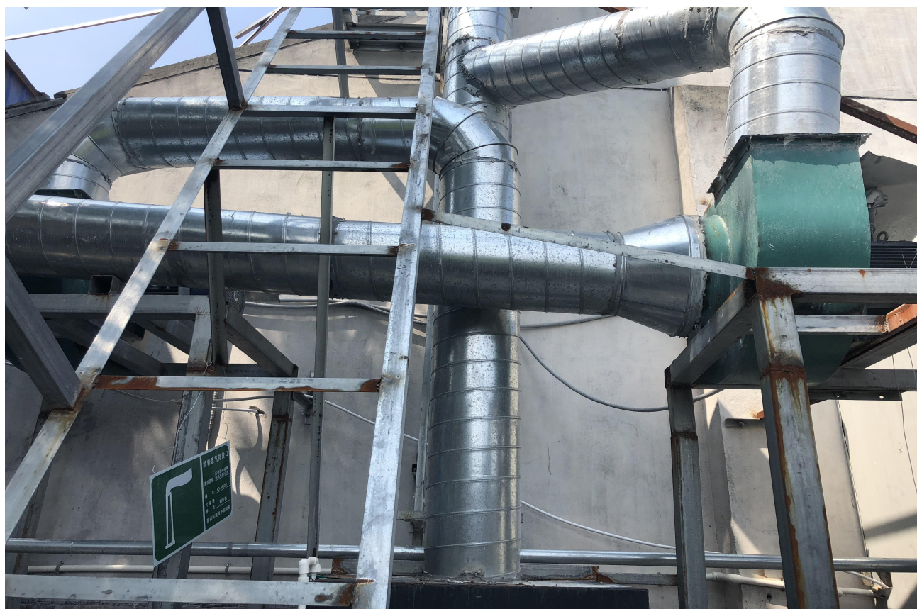
废气处理设备
