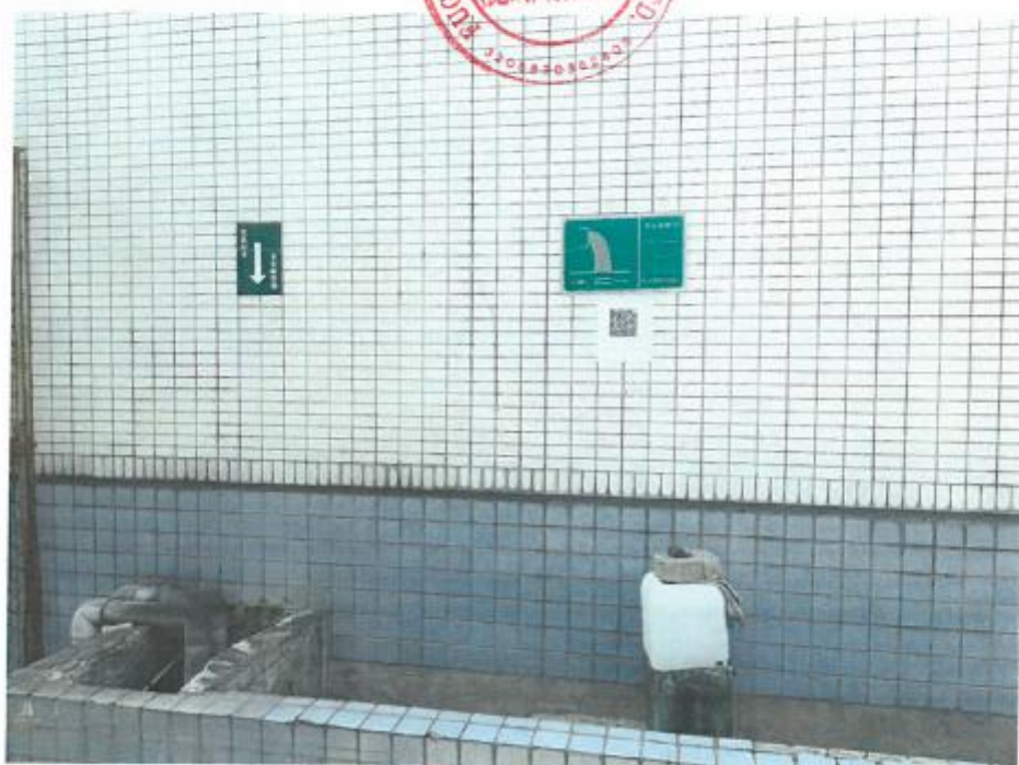
C 区生活污水排口
