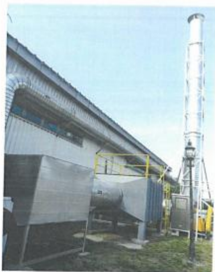
K 区焊接废气筒
