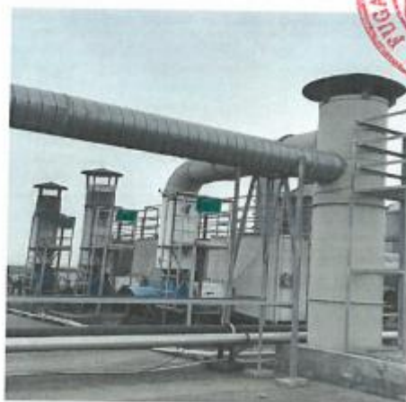
二次加工喷涂废气排气筒
