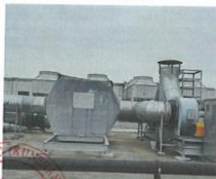
三楼通讯 SMT 粉尘排气筒
