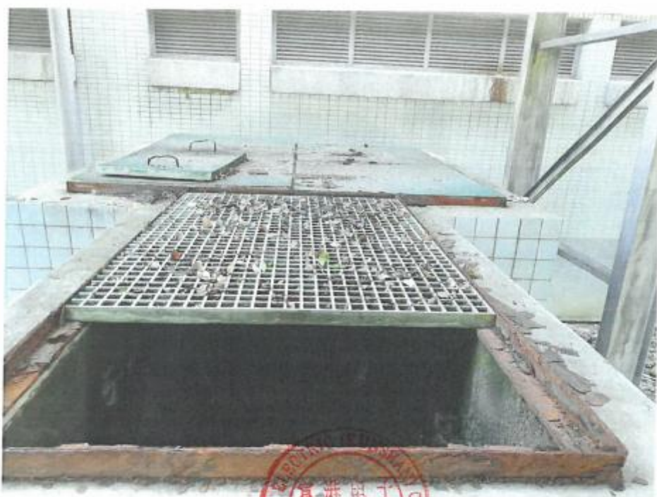
A 区生活污水排口
