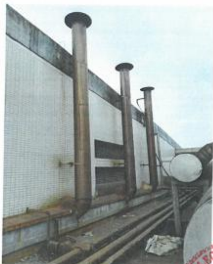
A 区锅炉排气筒 2
