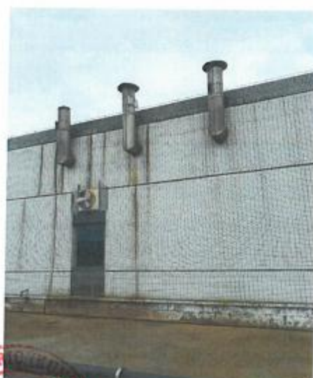
C 区锅炉排气筒
