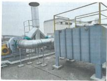
A 区线装焊接废气排气筒
