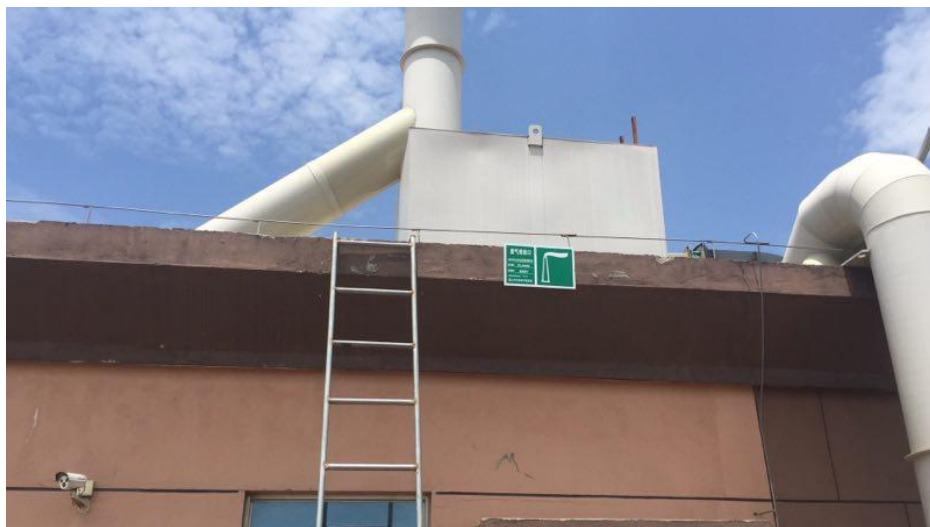
废气处理设施
