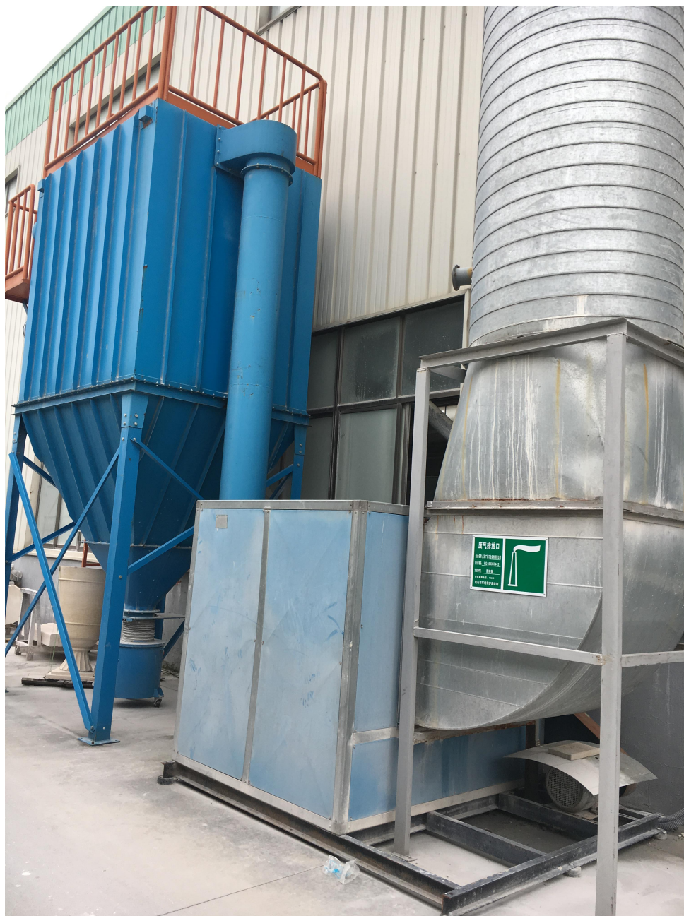
打磨车间西侧排气筒（FQ-083674-3）
