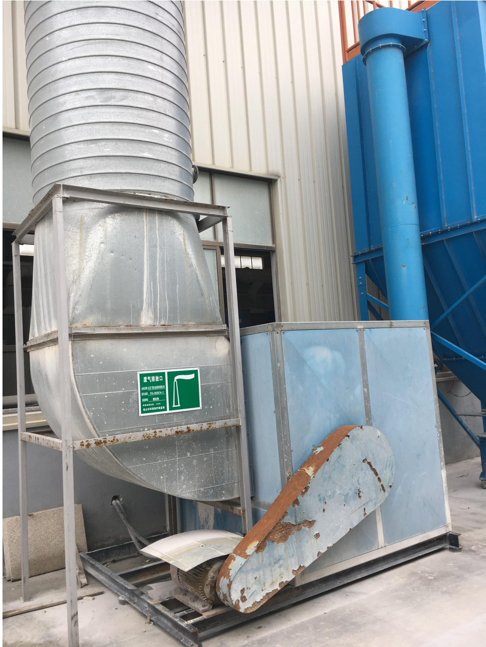
打磨车间东侧排气筒（FQ-083674-1）
