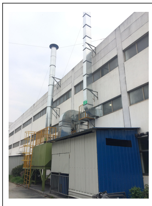
废气处理措施及排筒图片
